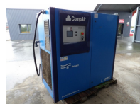
Installation de compression d'air: compresseur CompAir L37RS + assécheur d'air CompAir F95HS + réserve 900L + déshuileur - année 2017. La vente pour se lot ce fait en HT
